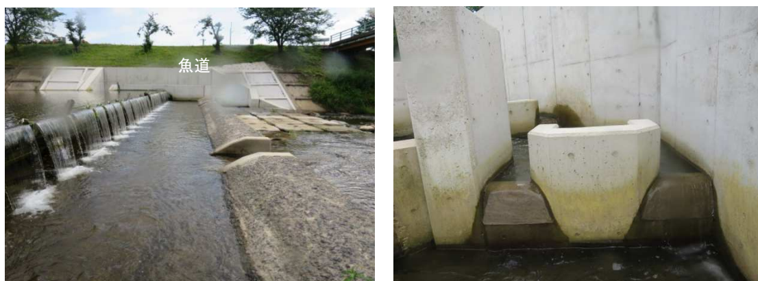
図 2-7 行恒地先の頭首工と魚道(右)。魚道最下段には大きな段差ができています。
