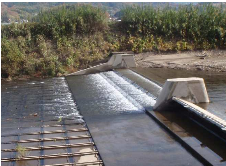
図 2-6 ゲートが転倒した状態。流速が速い上に剥離流となっているため、遊泳魚の遡上はきわめて困難（2012 年 11 月に撮影）
